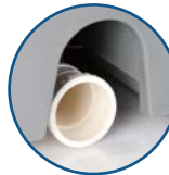
污水管道接口
